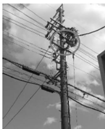
写真1 波及事故発生現場
