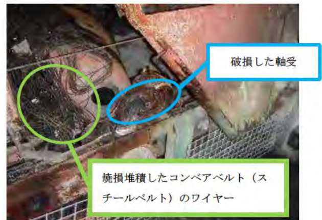
写真4 火災後のプーリー部
