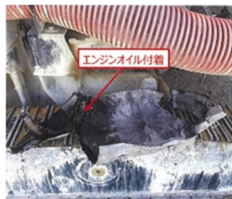
写真３ 発火直後のラギングカバー
