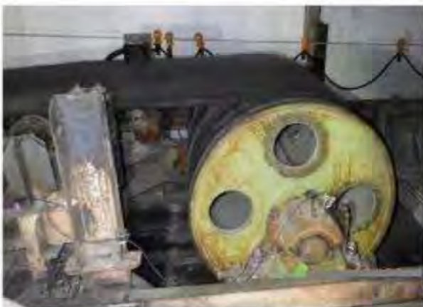
写真3 通常時のプーリー部
