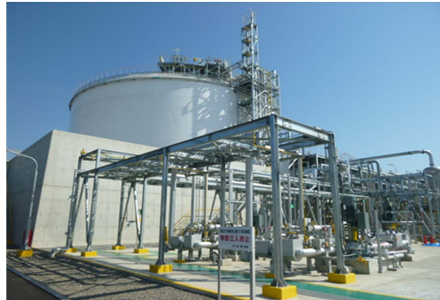
高圧ガス施設
