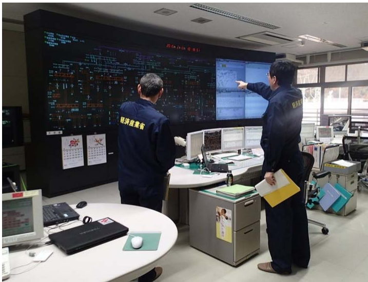
電力安全課 立入検査
