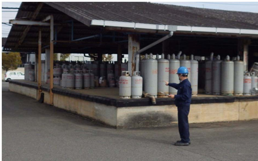
LPガス貯蔵設備
